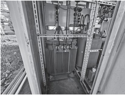
(扶桑東小学校の変圧器)
