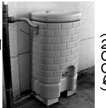
雨水利用貯留施設 (200ℓ)
