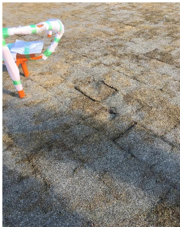
写真 4.2 芝生床土不良箇所 2
