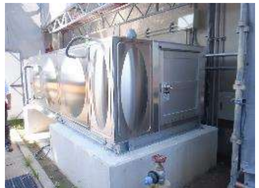
写真-3 災害用受水槽
