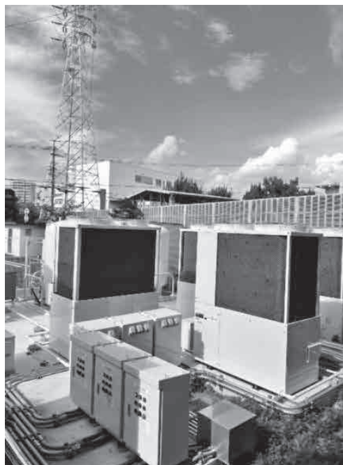
(大府市で設置されたLPガスヒートポンプ)
