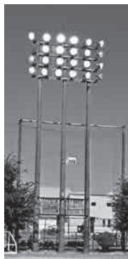
(総合グラウンド照明灯)
