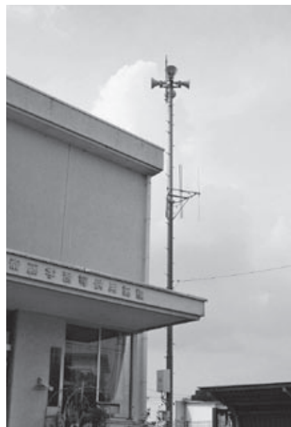
屋外用の防災行政無線機
