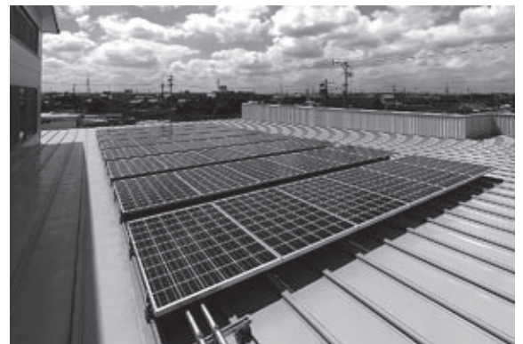
学校給食共同調理場の太陽光発電パネル 調理等に電力を提供！
