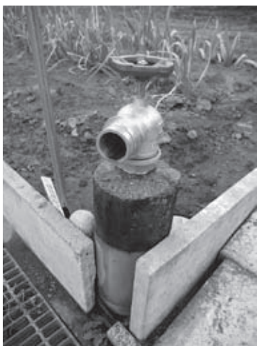
整備された畑かんの給水栓
