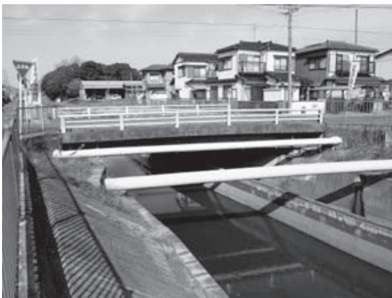
橋梁長寿命化修繕計画に基づき 修繕工事が予定される神明橋
