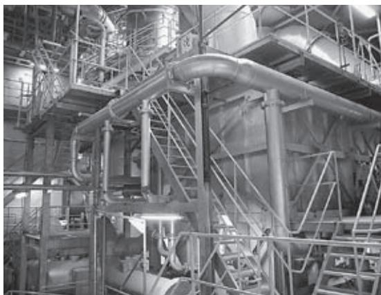
江南丹羽環境管理組合 環境美化センターの焼却炉
