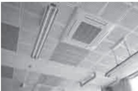
工事が完了した柏森小学校のエアコン 普通教室27室始め48室に設置
