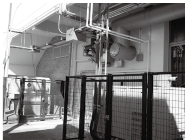
役場庁舎横に設置されている3台の非常用発電装置
