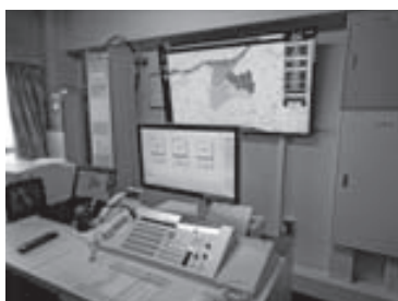
防災行政無線 親局設備 (扶桑町役場)
