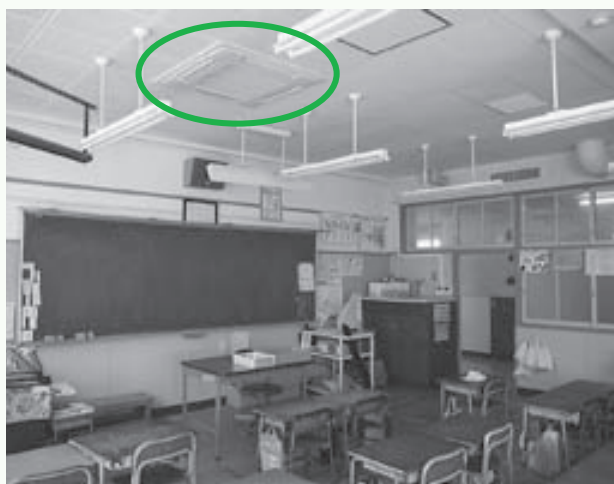
山名小学校（写真の○内 エアコン室内機）
