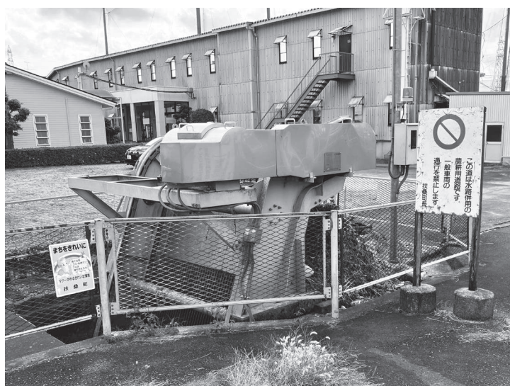
(巾下用水路に設置されている除塵機)
