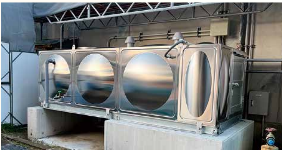
災害時の断水に対応するため 新たに設置したトイレ用受水槽（高雄小学校体育館）
